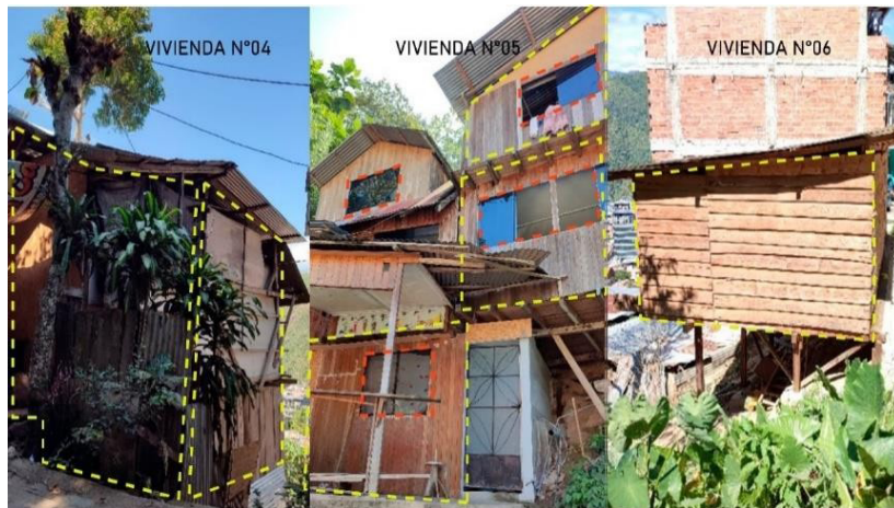
Figura 8. Carenca de sistemas estructurales: Derecha-Viviendas N°04, Centro-Vivienda N°05 e Izquierda Vivienda N°06.
