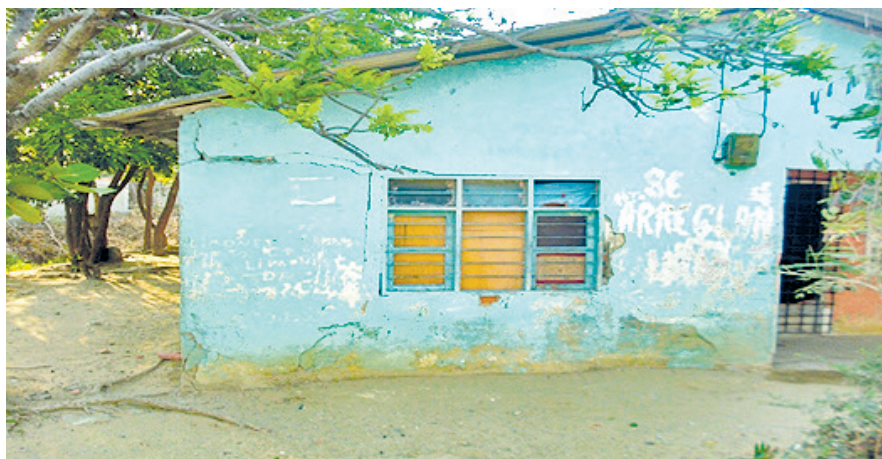
Figura 4. Estado de una vivienda afectada por el deslizamiento de terreno en el barrio Santo Domingo de Guzmán, Barranquilla.
