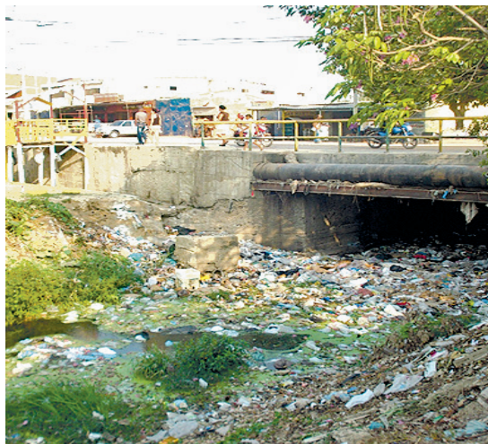
Figura 6. Inadecuada disposición de residuos sólidos urbanos en uno de los arroyos del sector
